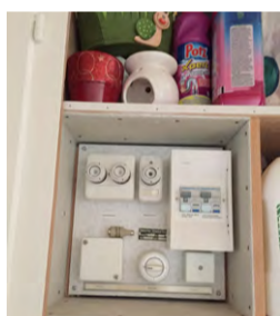
Schwachgebundener Asbest an den Seiten des Elektrokastens.
