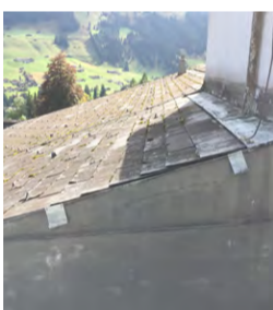
Festgebundener Asbest in Eternitplatten.
