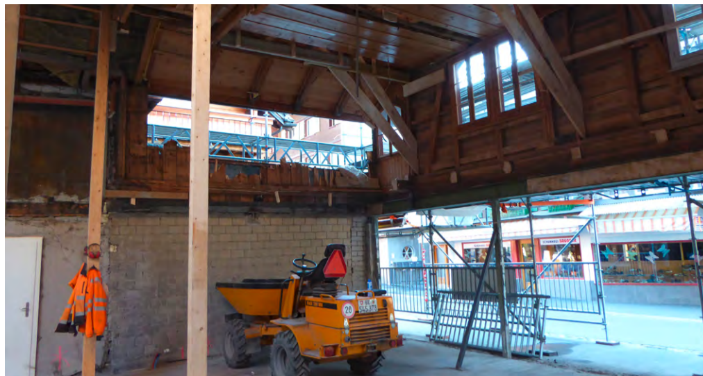
Die komplett ausgehöhlte Gebäudehülle, gestützt auf ein paar Holzpfosten.
