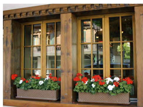
Heimatschutzfenster mit aussen aufgesiegelten Holzsprossen.
