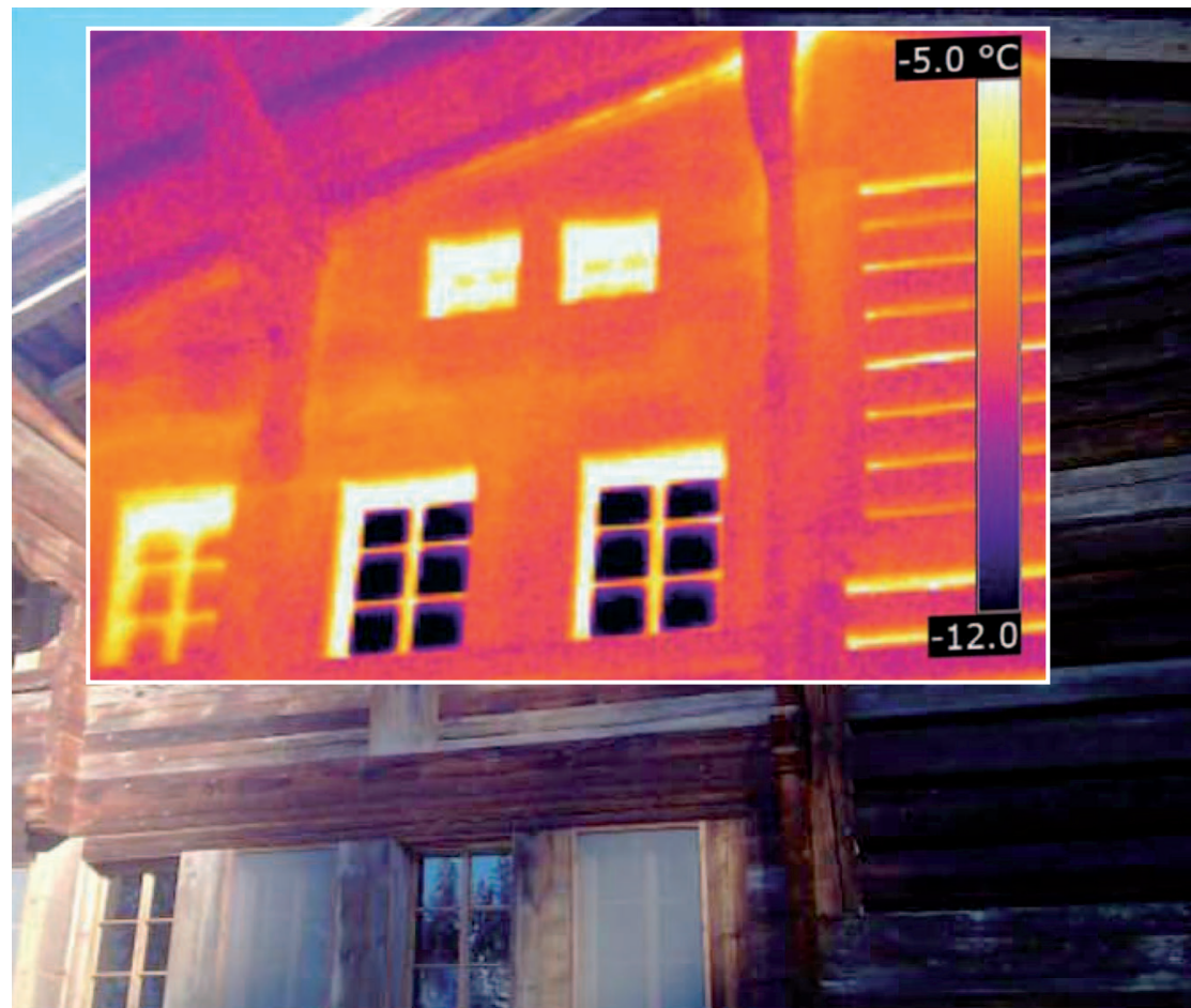
Das Thermografie-Bild zeigt die Schwachstellen auf: Je heller die Farbe, desto schlechter die Wärmedämmung.
